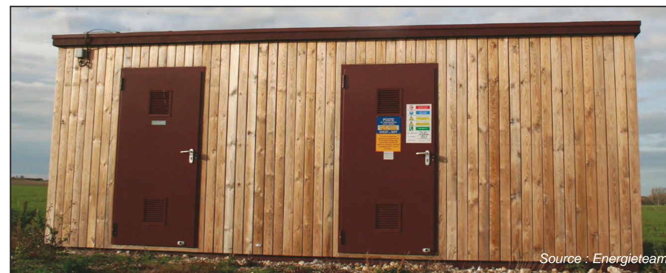
Exemple type de poste de livraison
